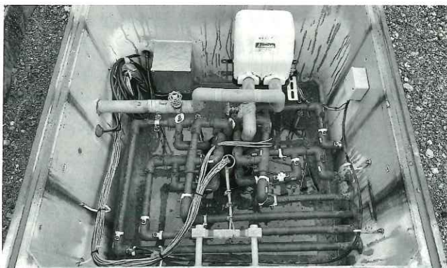
熱源井 (自噴井)
