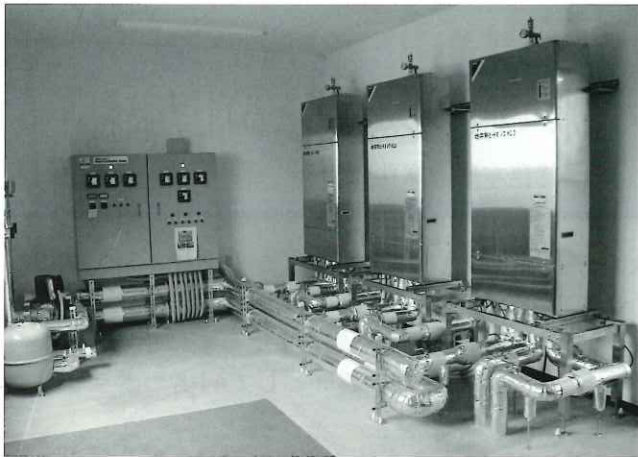
ヒートポンプユニット (10Kw×3基)
